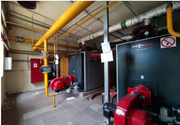
Поз. 1, 2. Котел Vitoplex 200 SX2A с горелками
